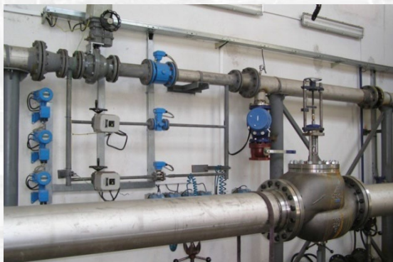
Měřicí trať pro měření charakteristik a Kv hodnot
